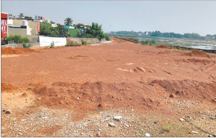
स्मार्ट सिटी से रिवर व्यू स्थित बाईं ओर की सड़क निर्माण का काम अधूरा।
