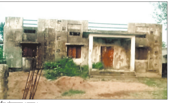
जर्जर पंचायत भवन।
